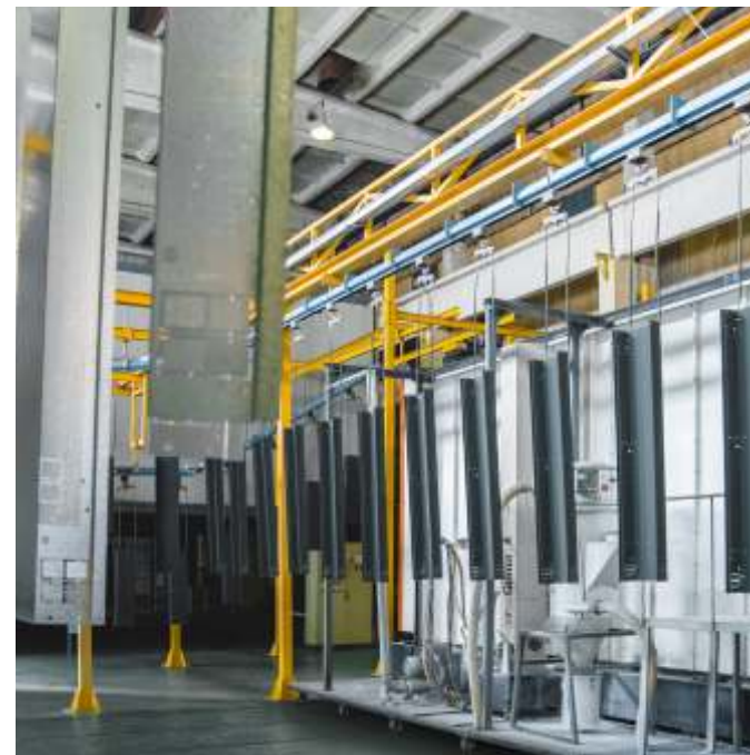
АВТОМАТИЧЕСКАЯ ЛИНИЯ ОКРАСКИ
